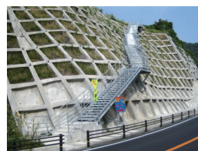
避難階段（静岡県沼津市提供）
